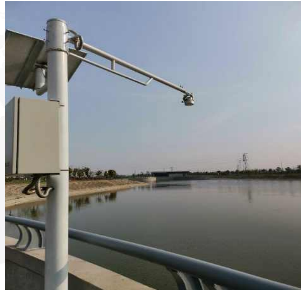
华东地区闸站
